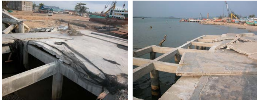
Fig. 21 Failure of Kao Lak Harbor dock
