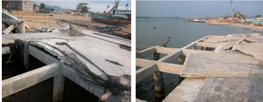
Fig. 21 Failure of Kao Lak Harbor dock
